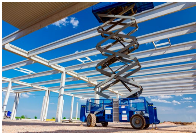
Messung der Hubhöhe in Scherenarbeitsbühnen
